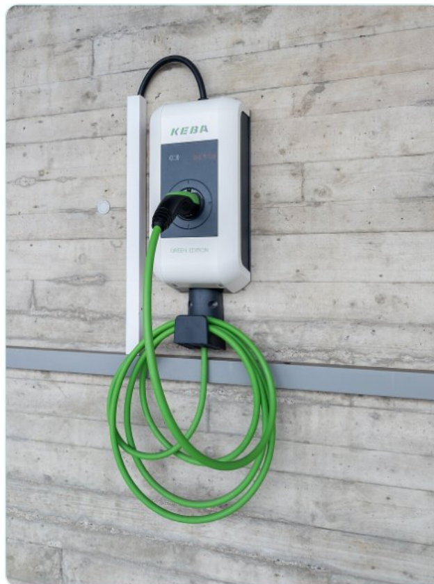
KEBA KeContact P30 (photo: Wikimedia Commons)
